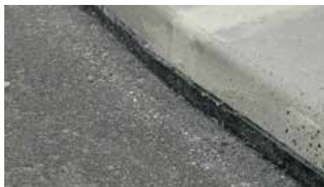
Unión de hormigón/asfalto (Stratos R1)
